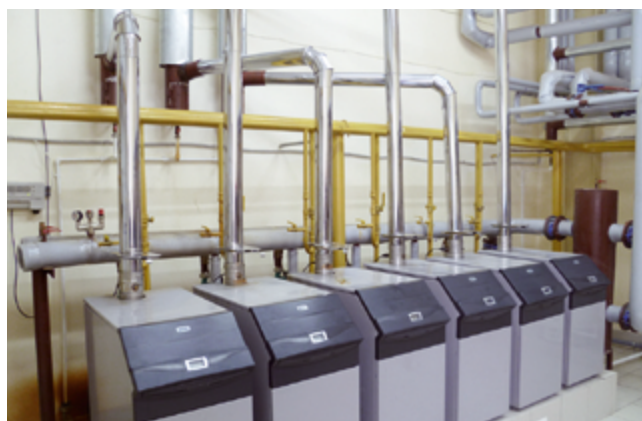
Автосалон Renault, г. Йошкар-Ола Общая мощность котельной — 600 кВт
