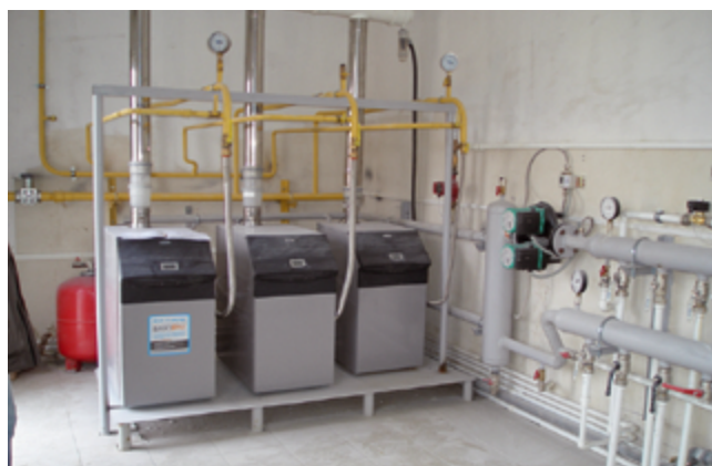
Здание рынка, д. Баранцево Общая мощность котельной — 265 кВт
