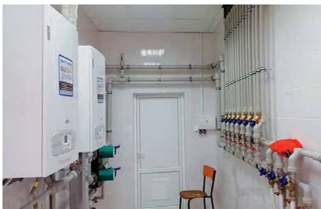
ТК «BB Passage», г. Геленджик Общая мощность котельной — 140 кВт
