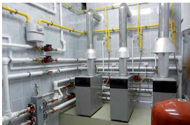
Магазин, г. Ковров Общая мощность котельной — 150 кВт
