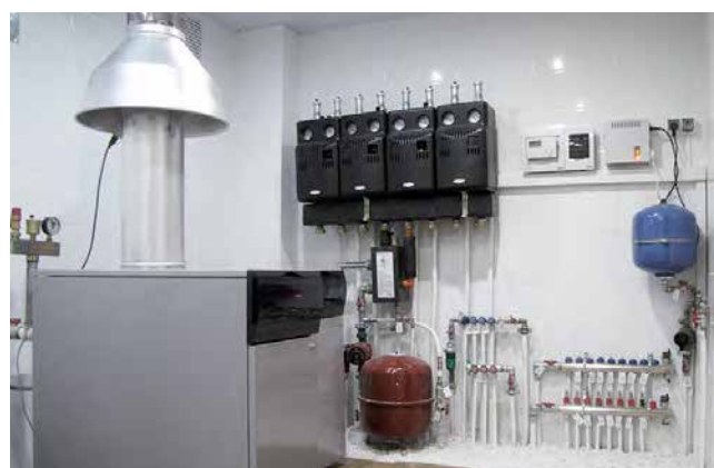
Частный дом, г. Чебоксары Общая мощность котельной — 62 кВт
