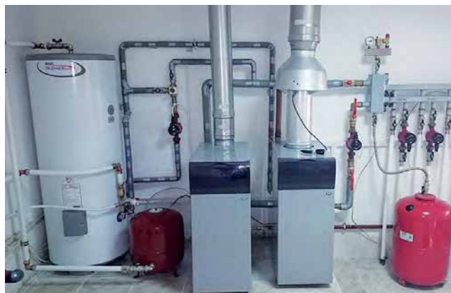
Жилой дом, г. Электросталь Общая мощность котельной — 92 кВт
