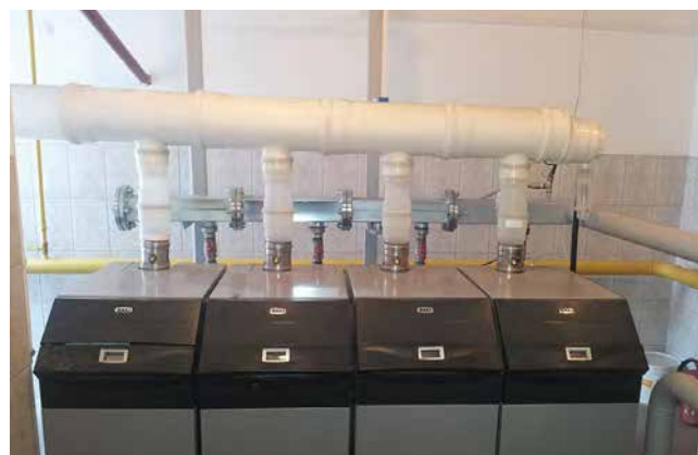
РЦ «Б-45», г. Калуга Общая мощность котельной — 400 кВт
