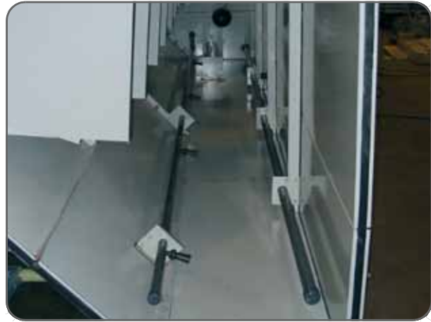
Бассейн холодной воды с трубопроводами очистителя бассейна
