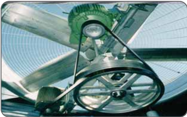
Рисунок 6. Градирия ВАС с осевым вентилятором, работающим от привода Baltiguard
