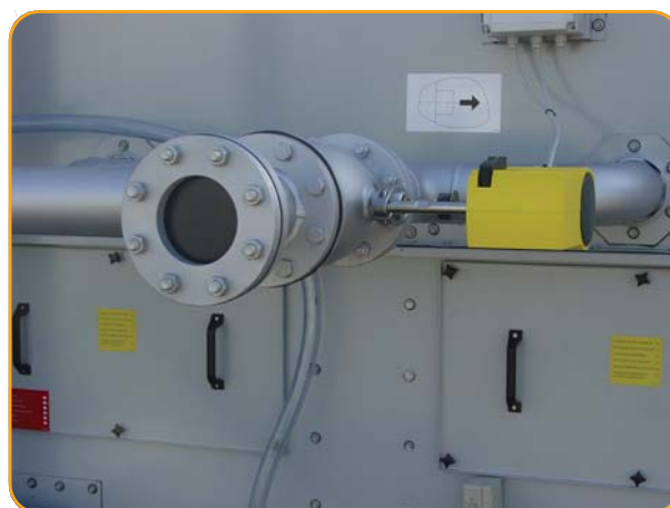
Блок управления расходом воды
