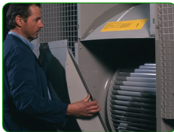
Кожухи вентиляторов поставляются незакрепленными
