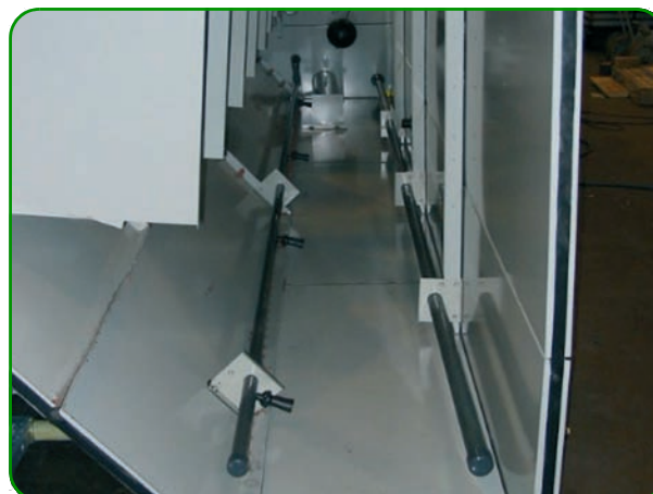
Трубы очистителя бассейна
