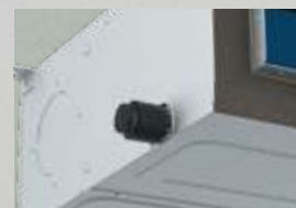
Вывод дренажа с двух сторон
