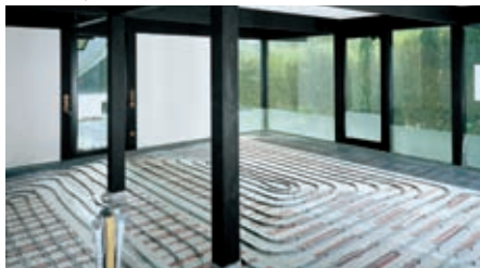
Система тёплого пола в жилом помещении
