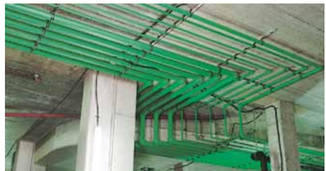
Трубопроводные линии для этажей
