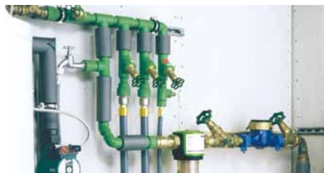
Точка ввода в здание
