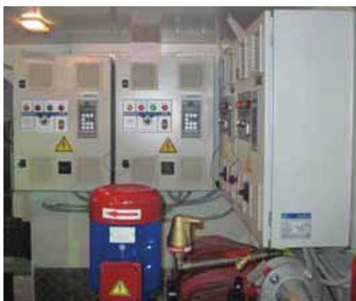
Москва Шафы АЭП40-025-54Ч-11А в аварийной машине Мосводоканала
