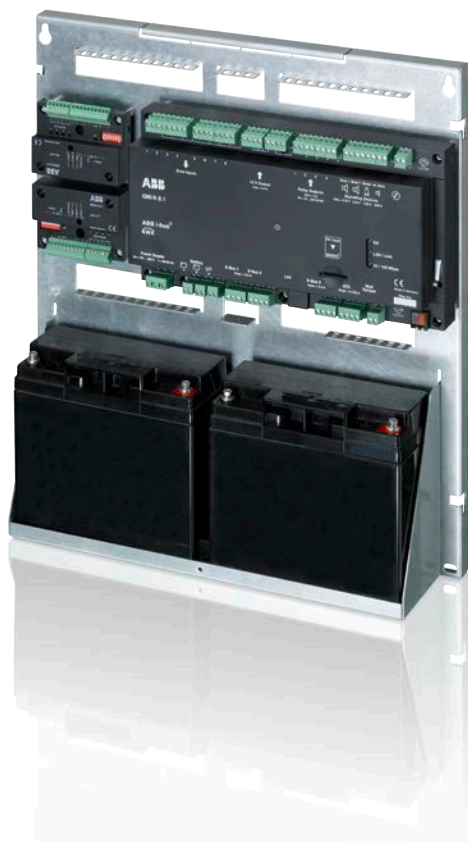
Панель системы безопасности KNX без крышки, интегральные модули зоны и батареи
